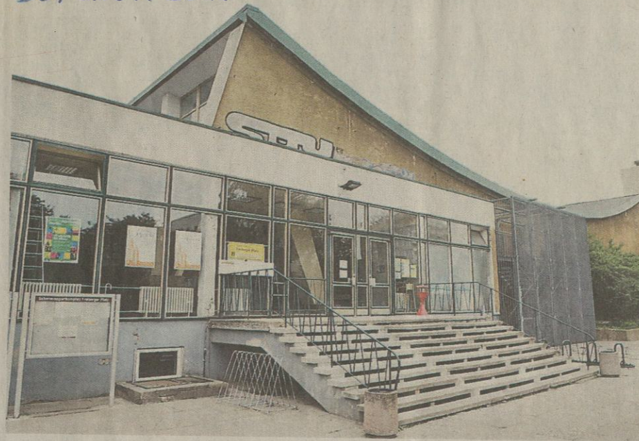
Die Schwimmhalle in der Freiburger Straße ist marode. Zur 14,25 Millionen Euro teuren Sanierung fehlen allerdings noch acht Millionen Euro.
